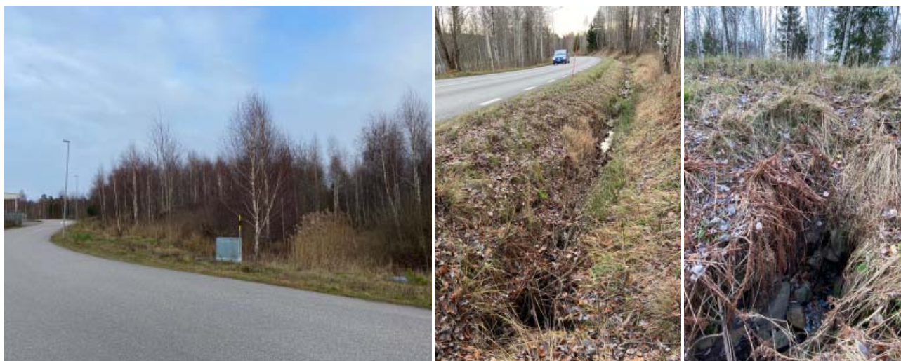
Dagvatten inom industriområde leds i huvudsak till en väl tilltagen våtmarksyta på östra sidan Kranvägen, centralt i området, vilken fungerar som fördröjning och rening. Därifrån breddar vatten ned i diket längs länsväg 243 och via två mindre stentrummor under vägen när det slutningen ned mot Agsjön/Letälven.
